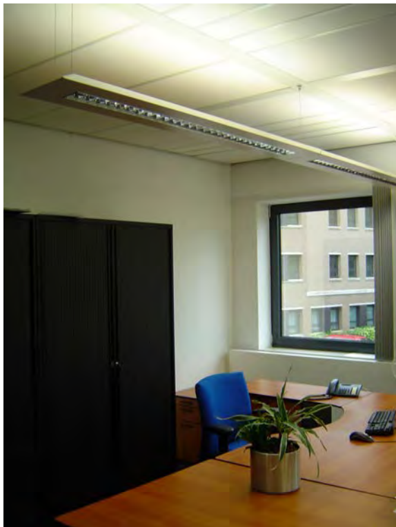
iGuzzini – locatie B – 1 e Verdieping – afdeling PR (handmatige bediening)
