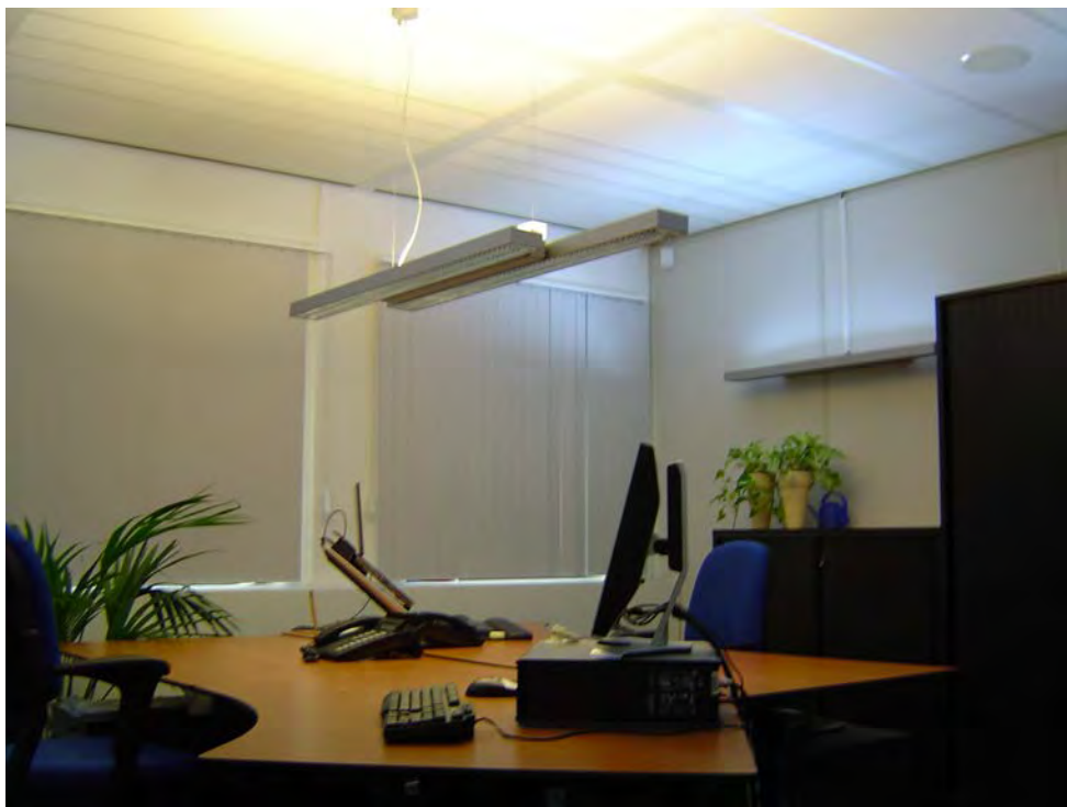
Trilux – locatie A1 – Begane grond - Bedrijfsbureau
